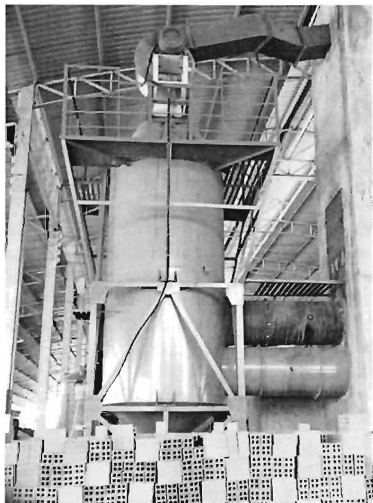
Hệ thống xử lý khí thải
