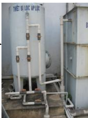
Hình 8. Bể lọc cát áp lực
