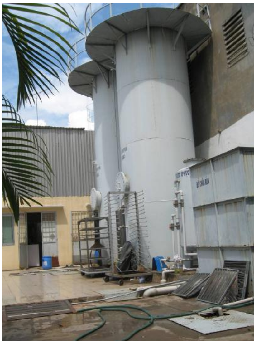
Hình 2. Hệ thống xử lý nước thải XNDPTW25
