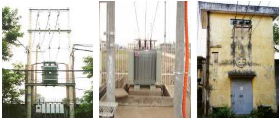
Hình ảnh thực tế: Trạm treo, trạm bệt và trạm kín
